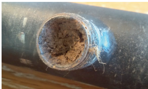
Der Sauerstoffeintritt begünstigt die Schlamm- bildung in den Heizschlangen und verstopft diese.
