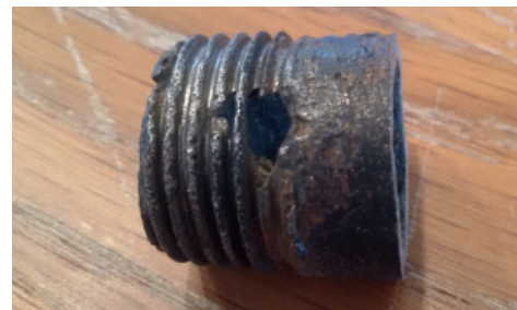
Das Eindringen von Sauerstoff fördert die Rost- bildung in Steigleitungen und Heizverteiltern.
