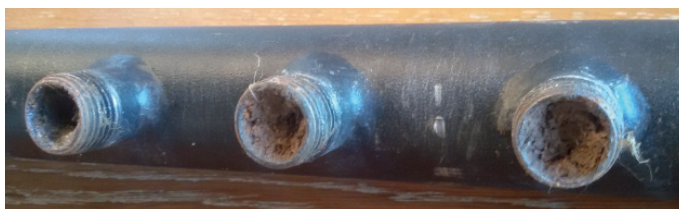
Das «Microclean»-Verfahren ermöglicht eine Tiefenreinigung der verschlammten Rohre ab der Heizzentrale, ohne dass dafür bauliche Massnahmen notwendig sind.
